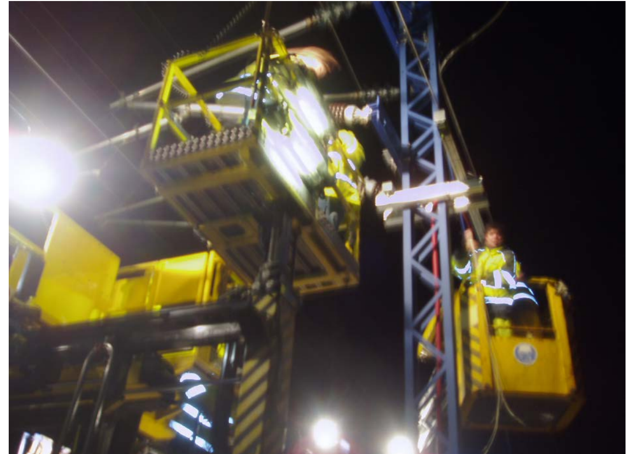
Colocación Sensores Magnetoresistivos en Anchuelo. IFZONE (Previo a SPZN)
