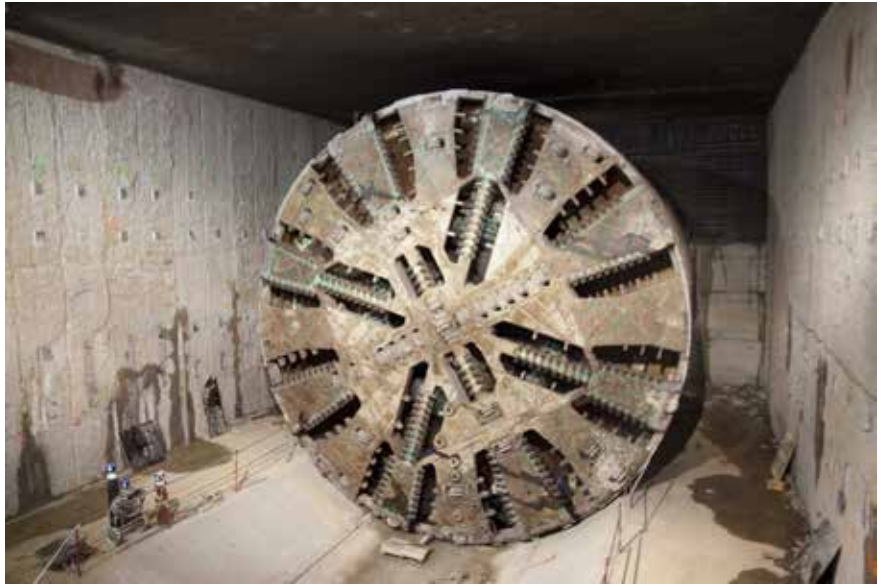
Detalle de la tuneladora
