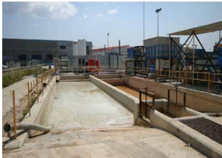
Sistema de tratamiento de efluentes
