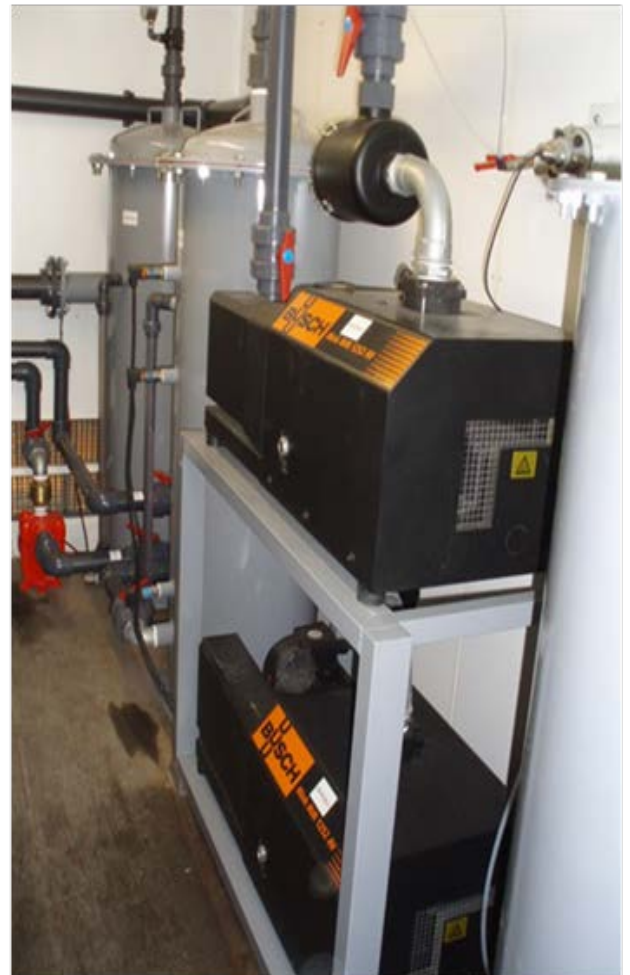
Bombas de alto vacío
