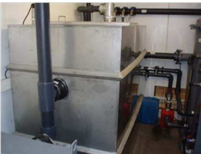
Separador de hidrocarburos
