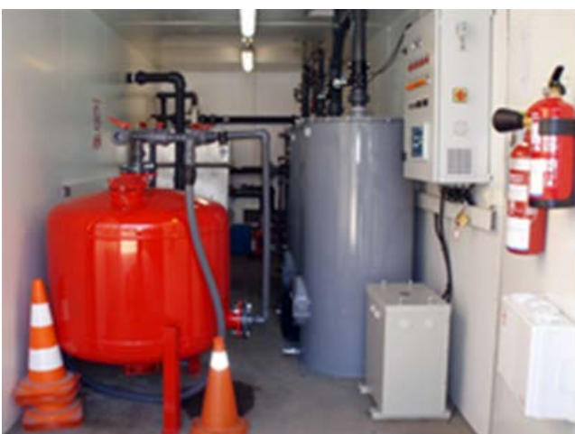
Planta de tratamiento de agua con filtros de carbón activo
