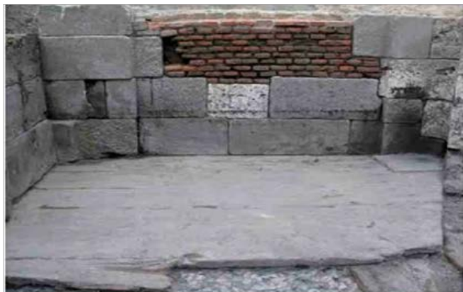
Solado del embarcadero, formado por un entarimado de grandes tabloncillos de una sola pieza.
