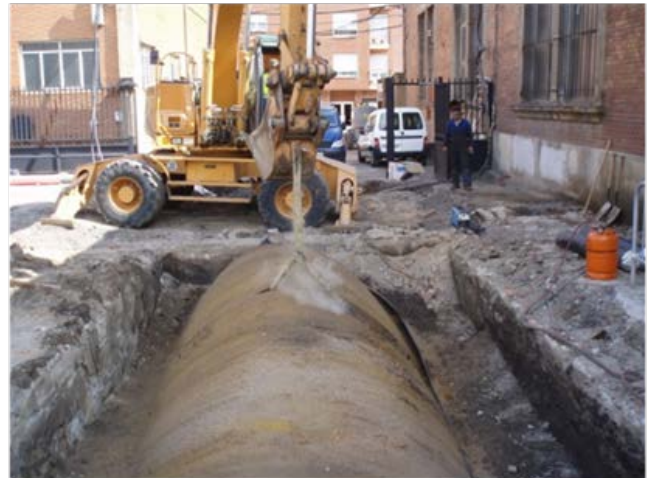
Retirada de tanque de combustible con fugas y excavación de suelo afectado
