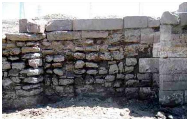
Detalles de la estructura principal del muro de contención este, formada por un paramento de mampostería de cal y canto muy deteriorado.
