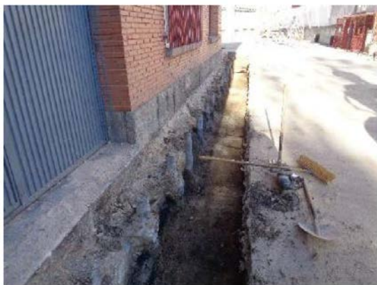
Trabajos en el taller de material motor y la zona de almacenamiento y suministro de combustible de Renfe y Adif en Salamanca
