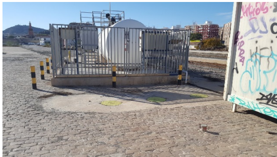
Figura 4. Depósito de combustible con piezómetro de control (Cartagena).
