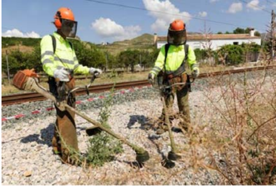
Figura 36. Trabajos de limpieza de la vegetación en los márgenes de la vía.
