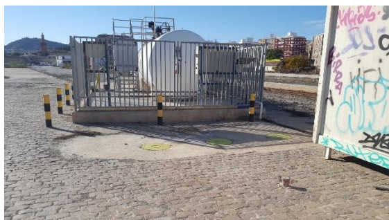
Figura 29. Depósito de combustible con piezómetro de control (Cartagena).
