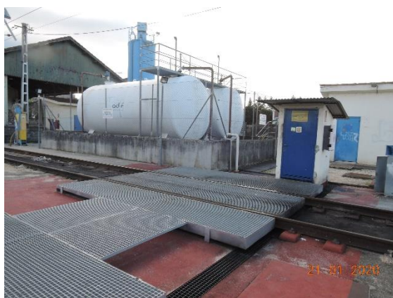
Figura 25. Instalaciones de depósito y suministro de combustible (Monforte de Lemos)
