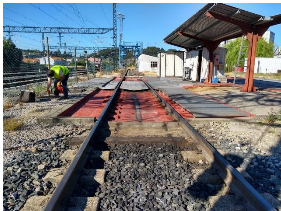
Figura 20. Punto de suministro de combustible (A Coruña).
