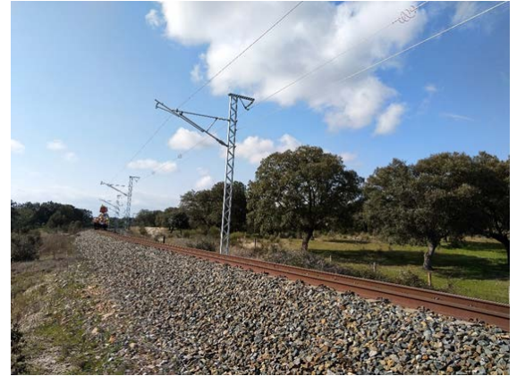
Figura 31. Medidas anticolidión colocadas en la línea aérea de contacto
