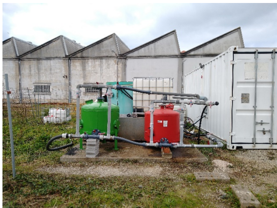
Figura 12. Módulo de remediación del emplazamiento de A Coruña.
