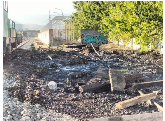
Figura 21. Zona afectada por la explosión del depósito en las proximidades de la vía en Albolote (Granada).
