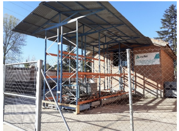
Figura 11. CAR en el Centro de Tecnología de Vía en Valladolid
