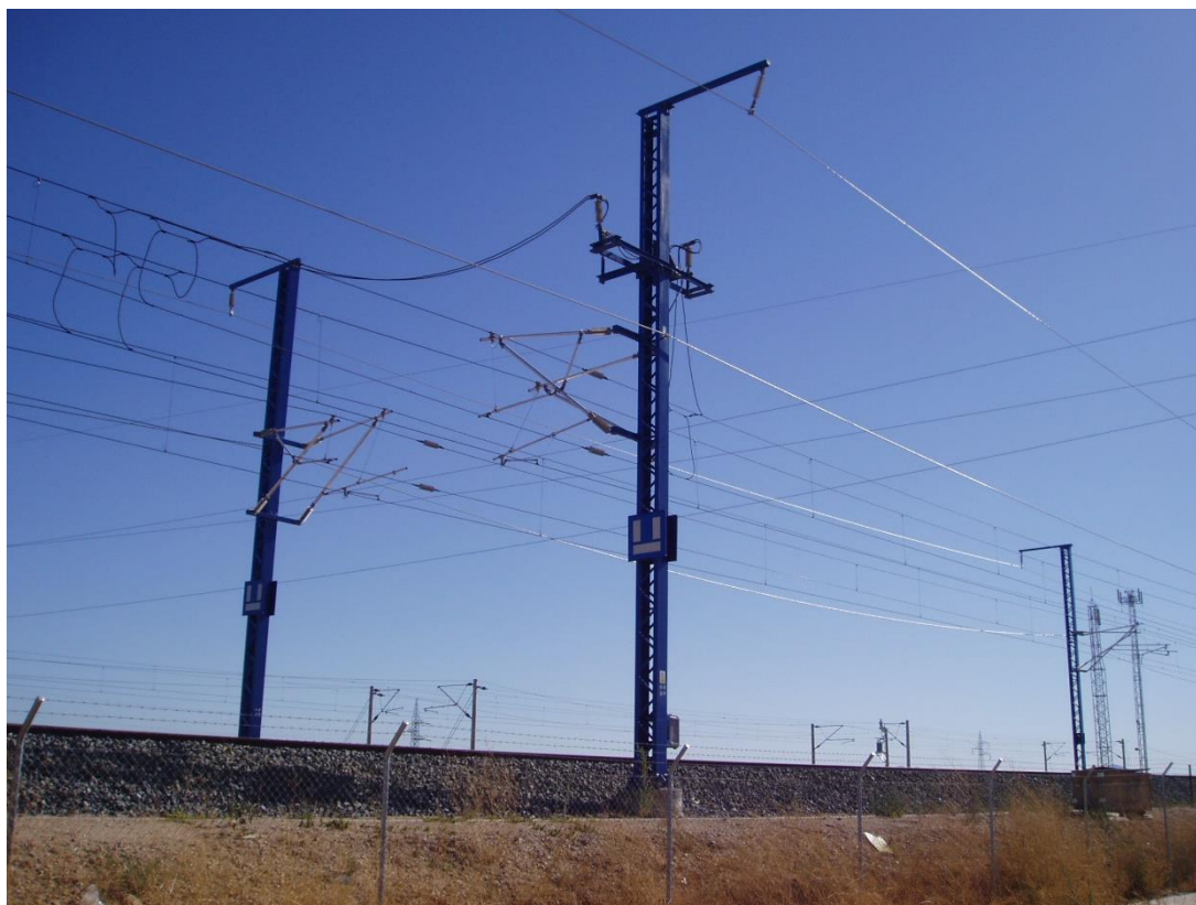
Figura 1. Zona Neutra de separación de fases eléctricas. (Fuente: Adif).
