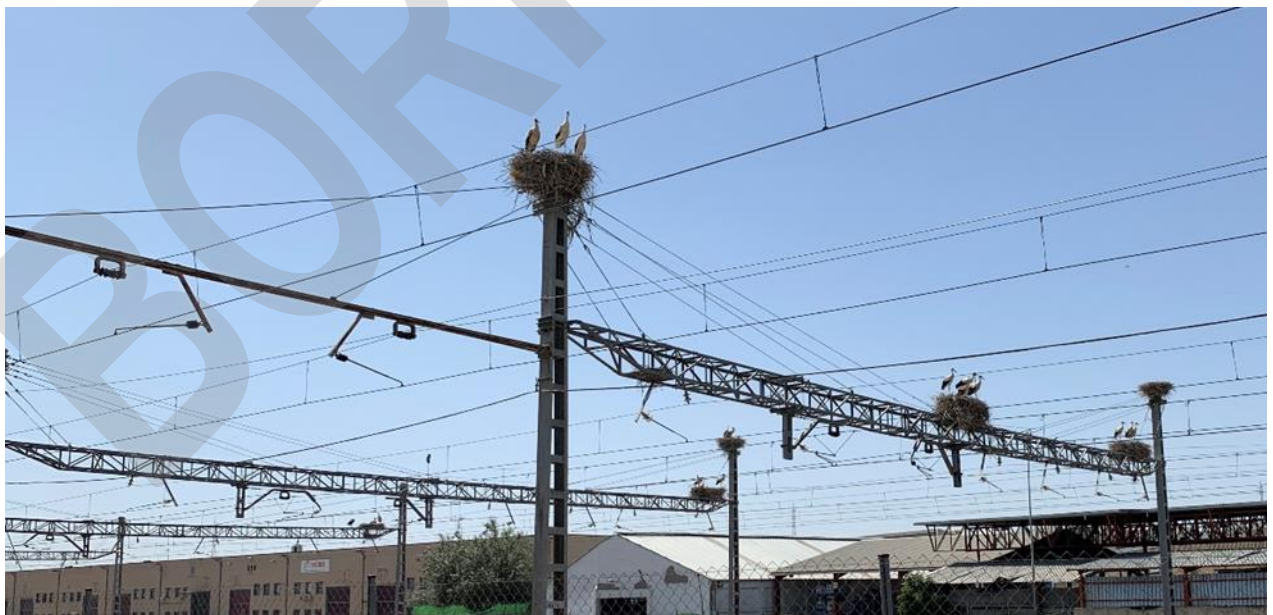
Figura 6. Nidos en cabezas de poste y dintel del pórtico.
