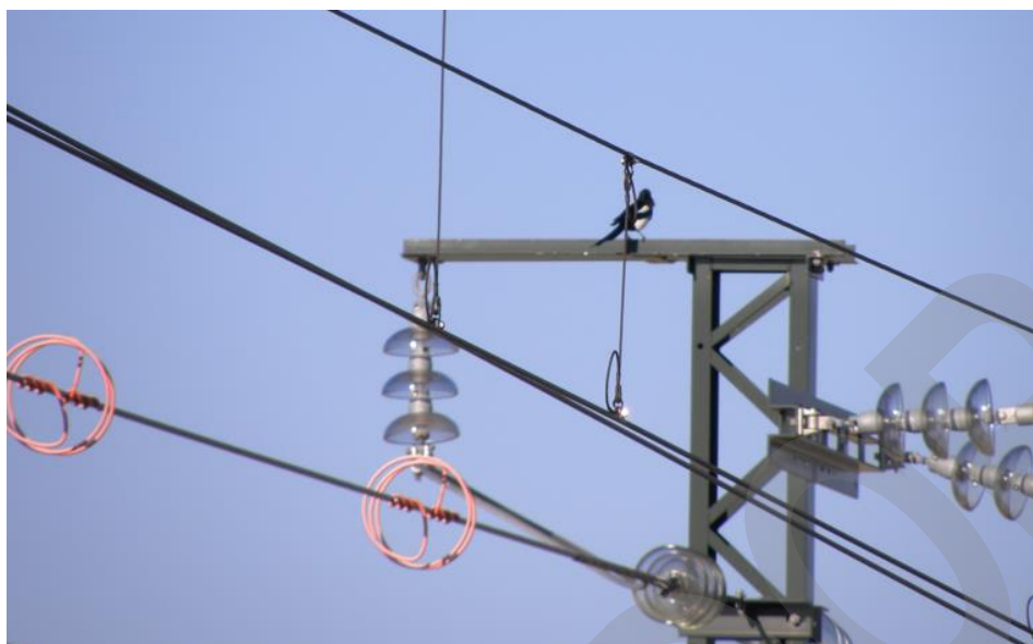
Figura 8. Dispositivos anticollisi3n en el cable de f3der.
