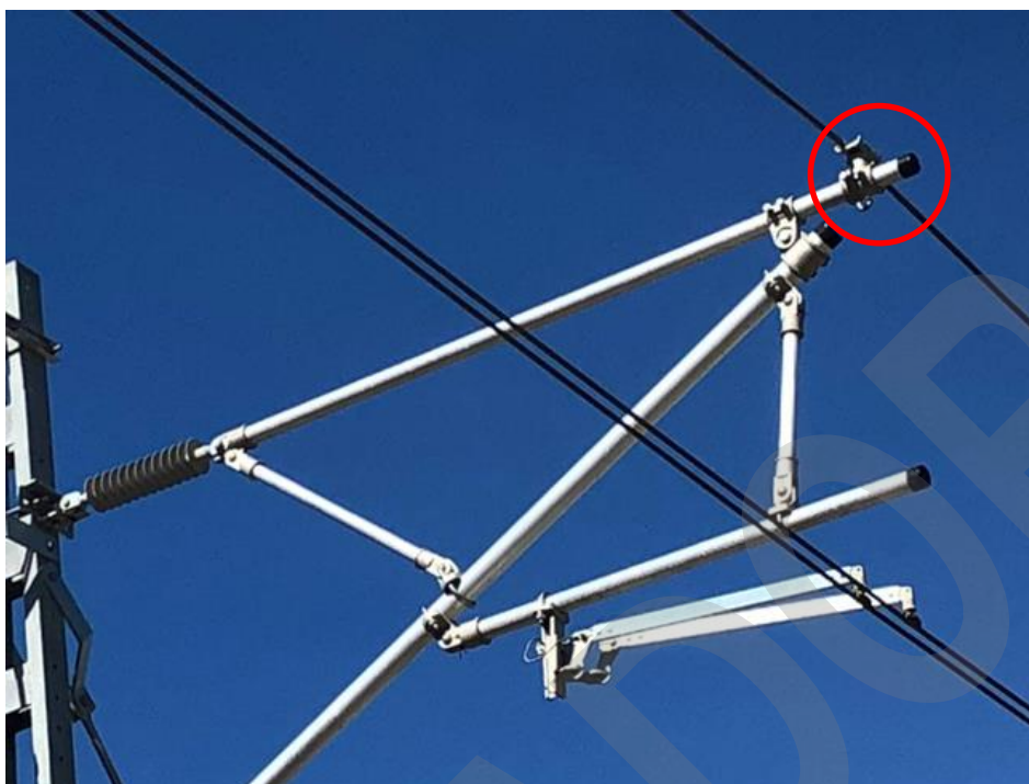
Figura 13. Conjunto de suspensión de fíder en catenaria tubular que no requiere protección.
